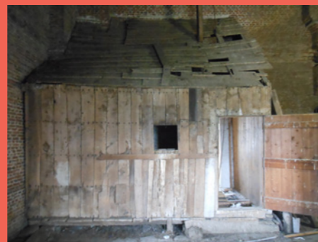
Kluisjes in de Sint-Gertudiskerk te Vorst Schuilhuisje in de Sint-Gertudiskerk te Vorst © Christof Tubebeckx
